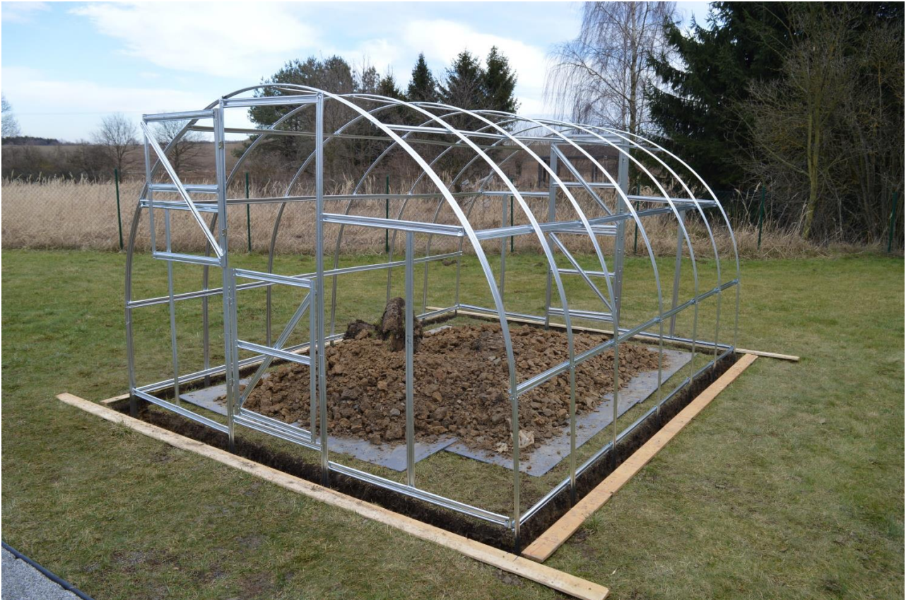
Ilustračný obrázok ukotvenia konštrukcie skleníka Kyklop (modelový rok 2017) do krajiny (Jednotlivé profily sa môžu svojou polohou odlišovať v závislosti od modelu, rozmeru a na roku výroby skleníka) princíp ukotvenie do zeme je zhodný u všetkých modelov rady Kyklop
